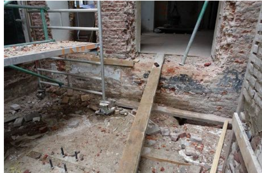
Detail onderzijde gevel, met links het getoogde kelderlicht. Onder de rechter opening is ook inboetwerk herkenbaar.
