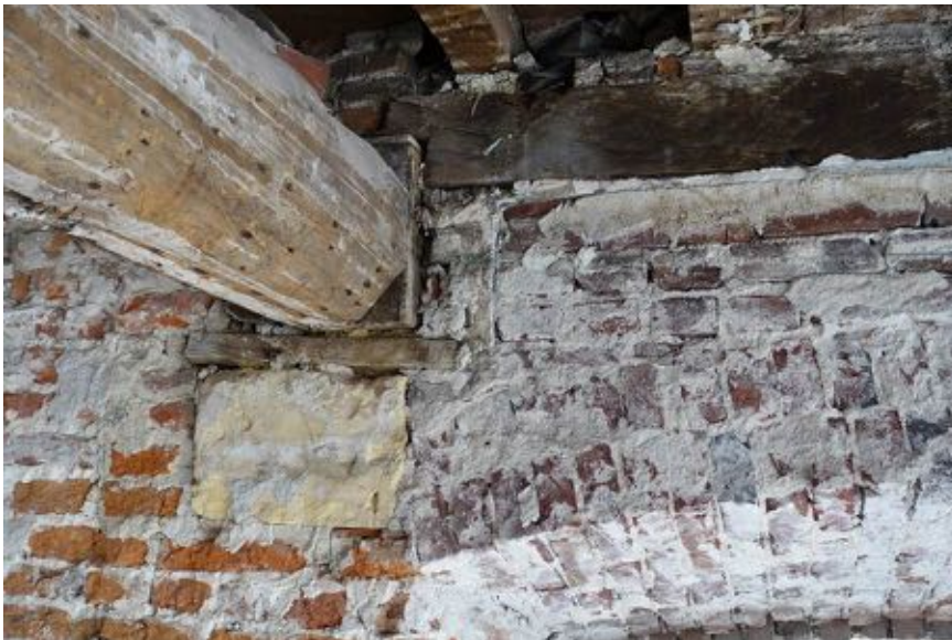
Oplegging van de in 1828 nieuw toegevoegde grenen onderslag in de linker zijgevel. Onder de balk een klos met daaronder een blok mergel.
