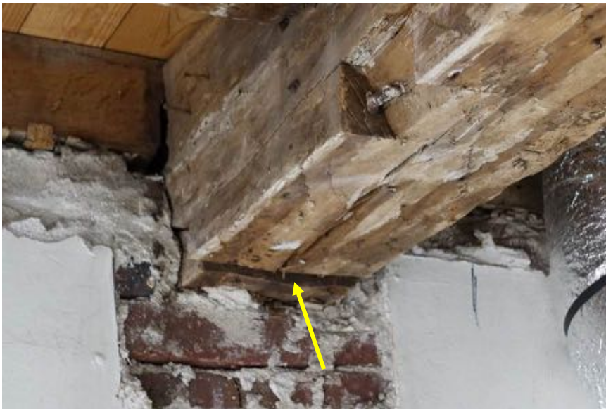
Bij de oplegging van de moerbalk in de wand tussen 03 en 04 is nog juist de rand van de schuine las herkenbaar (pijl).
