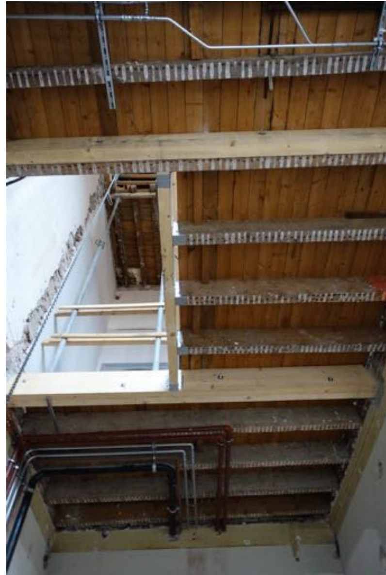
Balklaag uit 1912 boven ruimte 02, met recente raveling ter plaatse van de liftsparring.
