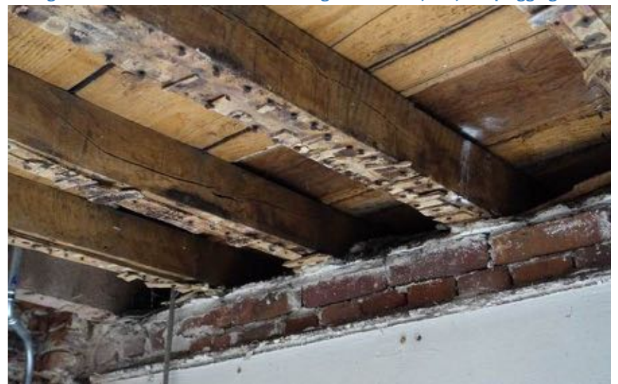
Bij de rechter zijgevel steken de kinderbinten (en het stucplafond) door boven de beklamping uit 1912.
