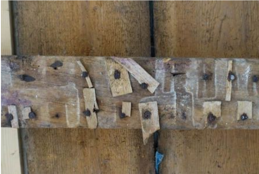
Detail van de restanten van grenen stucdragers tegen onderzijde kinderbint.
