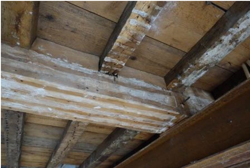
Detail van de grenen moerbalk. Boven de latere ijzeren ligger is de aftekening van het stucplafond onderbroken, wat kan wijzen op een hier eerder aanwezige wand.
