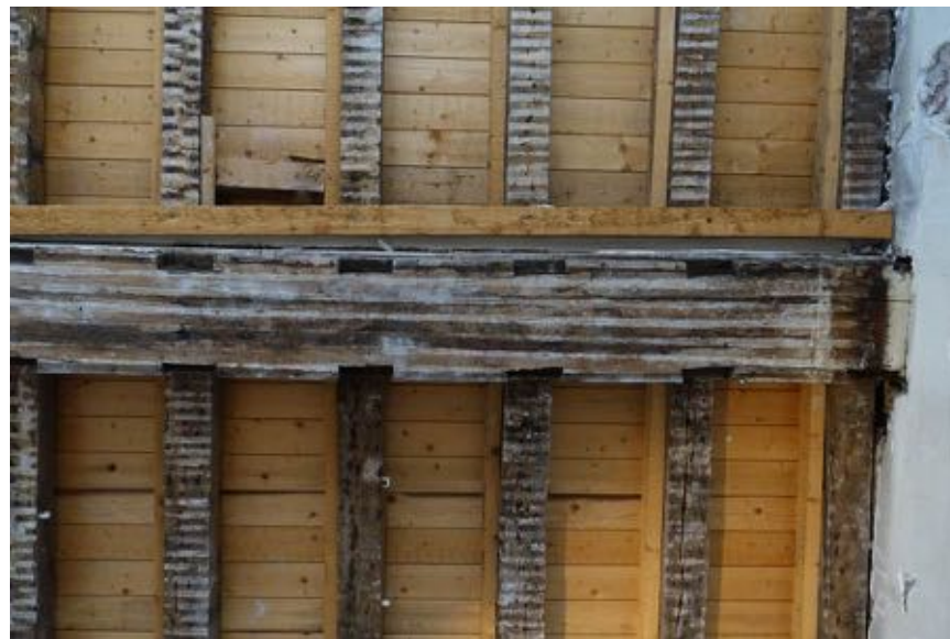
Onderzijde voorste deel van de hergebruikte moerbalk.
