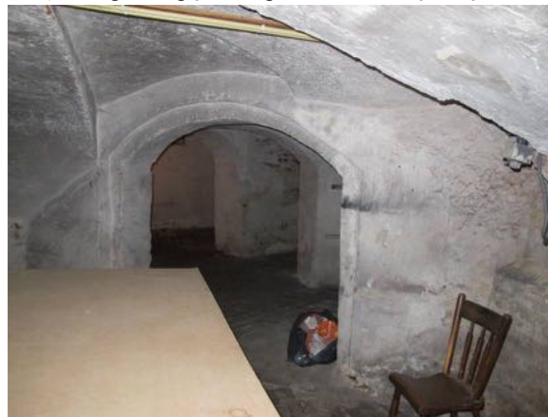
Schuin geplaatste kelderwanden bij aansluiting middenmuur op voorgevel.
